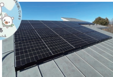
寄贈した太陽光パネル にしのりこども園(群馬県)にて
